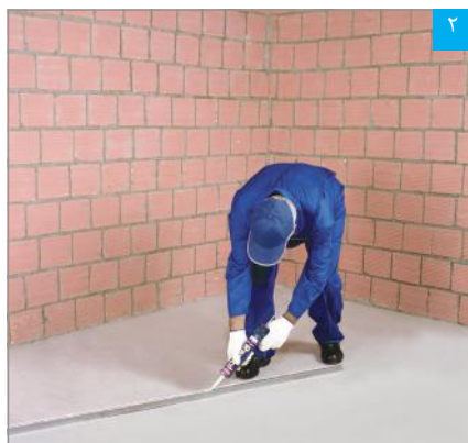
۲ اجرای دو ردیف خمیر درزبند (یا نوار عایق) بر پشت سازه‌های هادی کف و سقف
